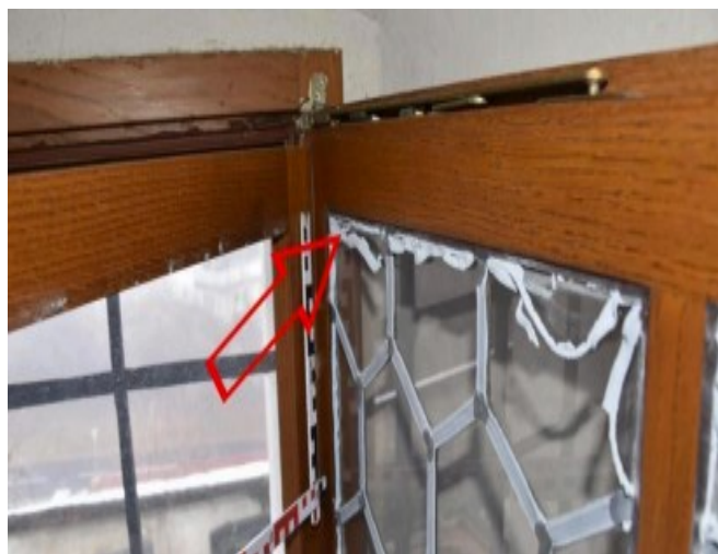
Schäden beim Silikon
